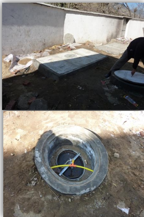
材料入り口とガス取り出し口：簾誼小学校
