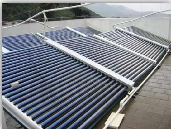
設置された太陽光パネル：白雲小学校
