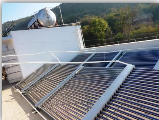
太陽温水器システム：白雲小学校
